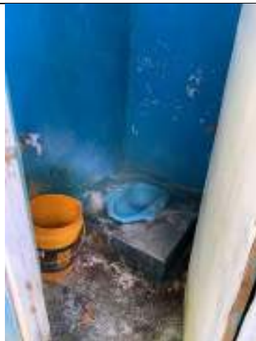
Kondisi toilet umum di Pantai Batu Kalang
