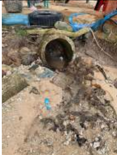
Kondisi saluran pembuangan limbah di Pantai Batu Kalang
