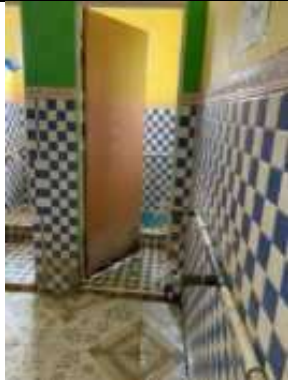
Pintu toilet yang tidak kedap air
