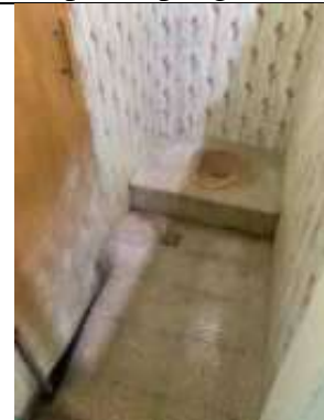
Toilet yang kurang bersih
