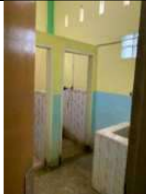
Lantai toilet yg jarang di kuras
