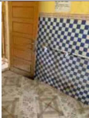
Lantai toilet yang kotor
