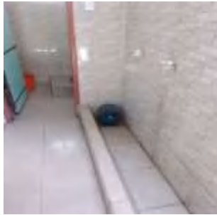
Kondisi toilet Masjid Al Miad
