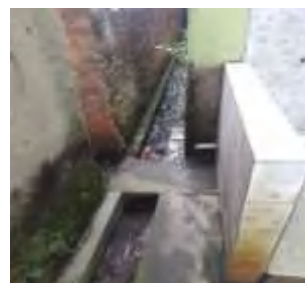
Kondisi saluran air limbah Masjid Insan Taqwa
