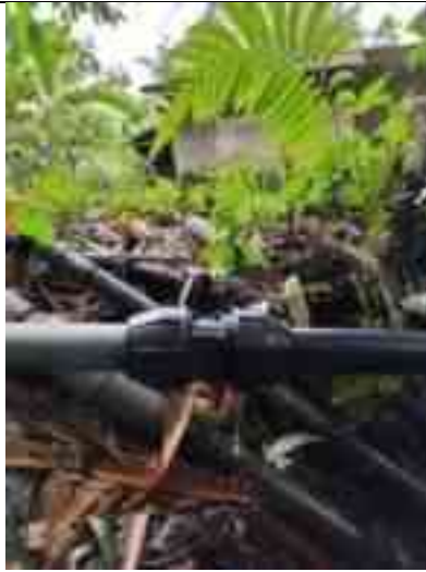
Kebocoran pada perpipaan
