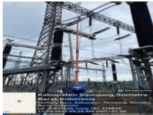
Grounding pada Gardu Induk
