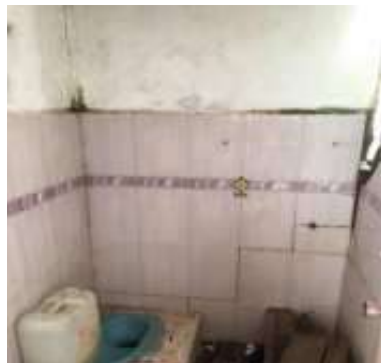
Kondisi dinding bangunan jamban yang roboh akibat gempa bumi di Nagari Kajai Kecamatan Talamau
