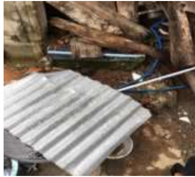
Kondisi sarana air bersih korban gempa bumi di Nagari Kajai Kecamatan Talamau
