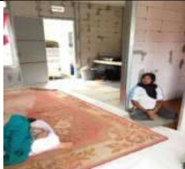
Kondisi rumah bantuan bagi korban gempa bumi di Nagari Kajai Kecamatan Talamau
