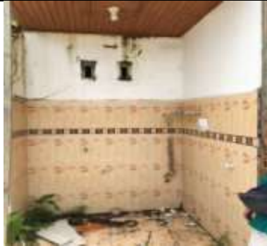
Kondisi dinding bangunan sarana jamban yang rusak akibat gempa bumi di Nagari Kajai Kecamatan Talamau
