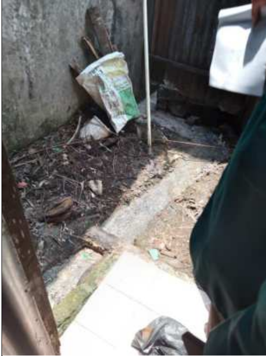
Kondisi selokan yang Kotor dan berdekatan dengan Pabrik Roti
