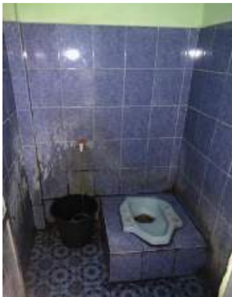
Kondisi toilet di Pasar Inpres Painan kotor dan berbau
