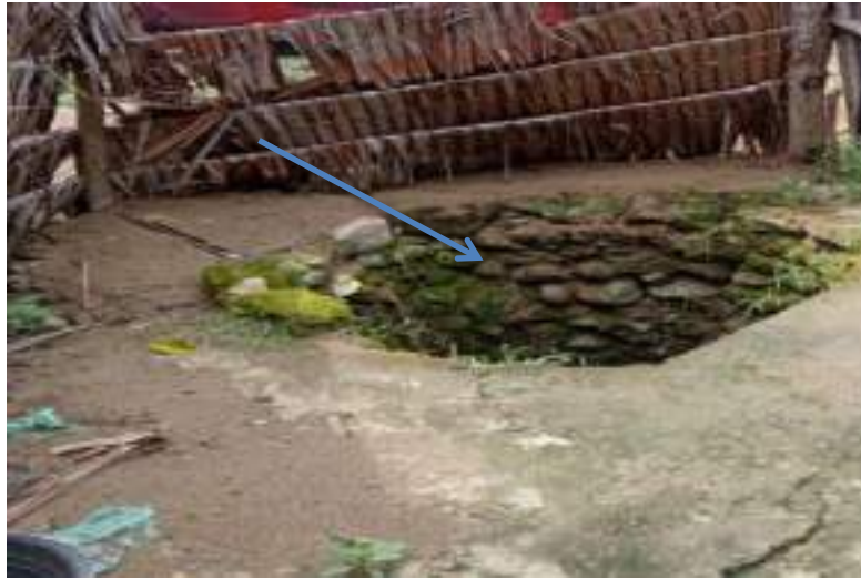
Gambar 4.3 Kondisi sumur gali terdapat konstruksi sumur yang tidak terdapat cincin
