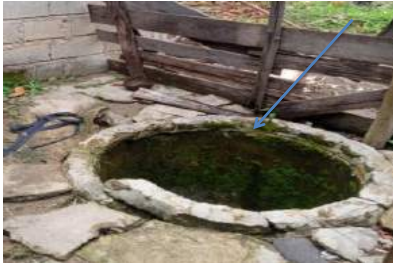
Gambar 4.2 Kondisi sumur gali terdapat konstruksi sumur yang bibirnya tidak sempurna
