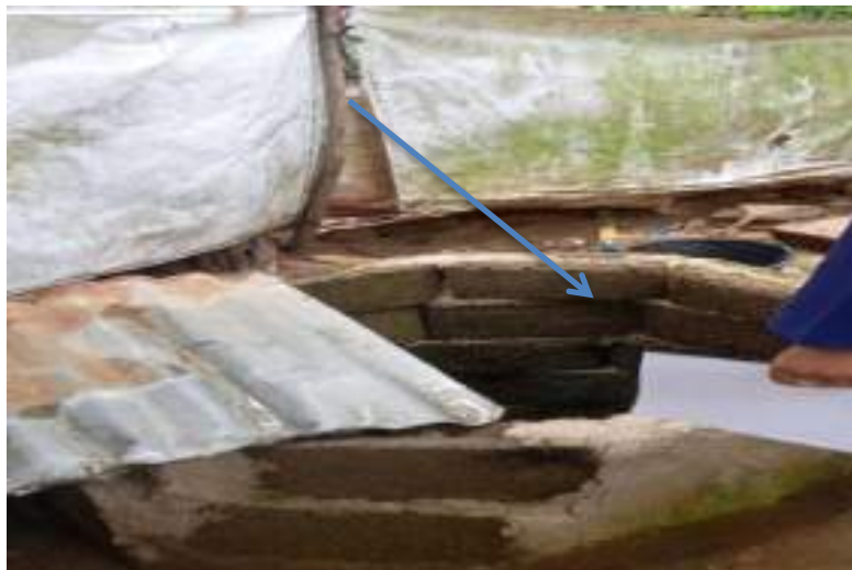
Gambar 4.4 Kondisi sumur gali terdapat konstruksi sumur yang tidak terdapat dinding sumur yang diplester
