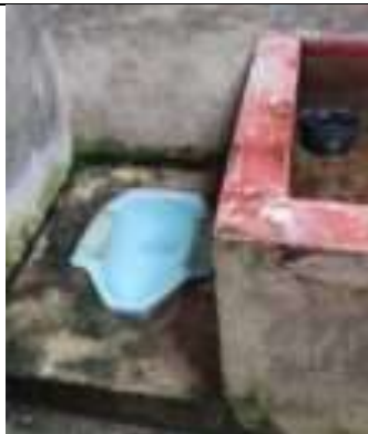
Jenis jamban leher angsa dengan septic tank
